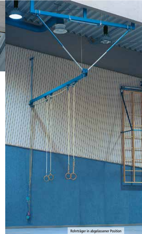
Rohrträger in abgelassener Position
